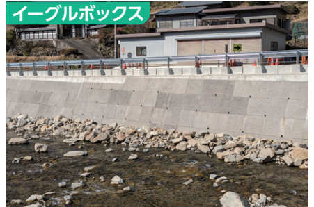
可茂土木事務所：恵那白川線 白川町
