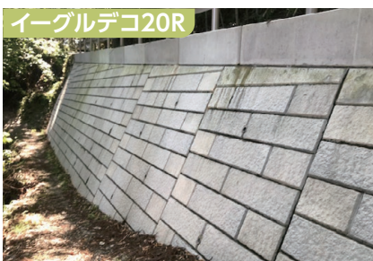
イーグルデコ20R 浜松市役所：天竜相津線線道路災害復旧工事
