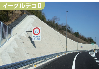
イーグルデコII NEXCO西日本：草津ジャンクション 草津市
