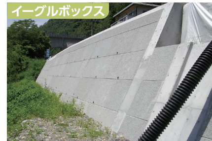
イーグルボックス 美濃土木事務所：一級河川長良川 美濃市
