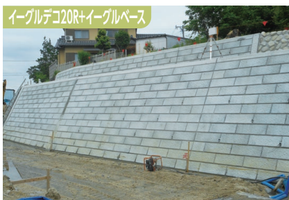
イーグルデコ20R+イーグルベース 四日市建設事務所：杉谷川災害 菟野町
