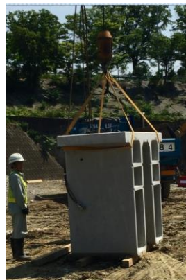
補巻フックのスリングベルトで製品をバスケット吊りにする。 主巻フックの吊り金具を吊り穴に入れロックする。
